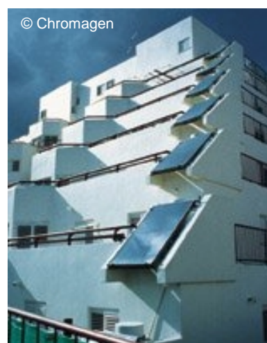
Figure 2 – Chauffe-eau solaire sur immeuble de Chromagen
