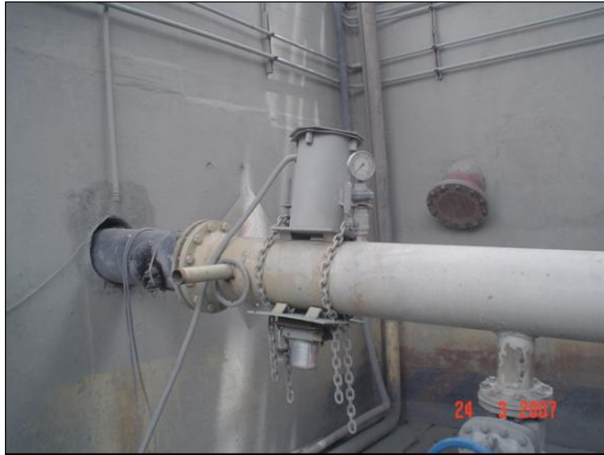
Figura 2.- Sistema de medición de la densidad con la fuente GG-5574. La fuente se ubica en la parte inferior del ducto y en la parte superior tiene un detector de NaI(Tl)
